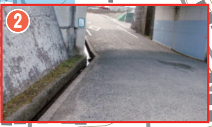
水はけが悪く、浸水の恐れ。浸水経験あり【写真②】
