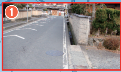
溝のフタがない。水があふれる危険性あり【写真①】
